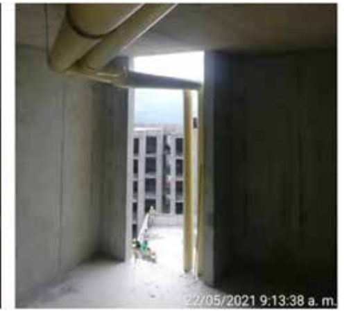
Bajante de agua lluvia hacia los tanques subterráneos.
