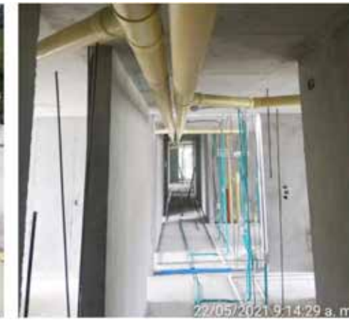
Sistema de conducción de agua lluvia por tubería pvc
