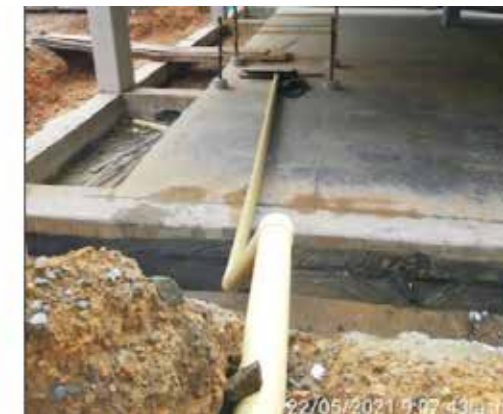
Ingreso de agua lluvia en tanques subterráneos
