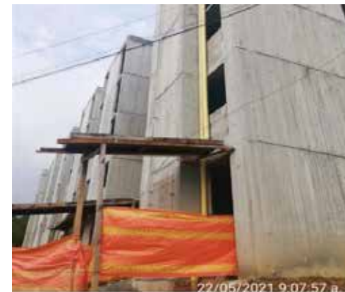
Sistema de tubería bajante de la torre hacia tanques
