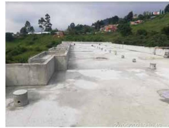
Terraza torre 1: Sitio de captación de aguas lluvias
