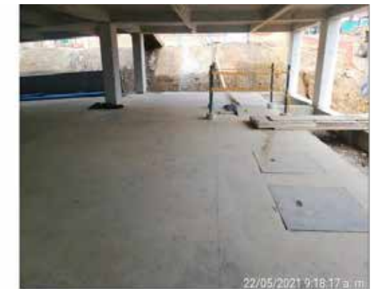
Se observa tapas de ingreso de agua a los 3 tanques
